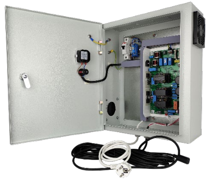
Шкаф управления на 1 ЭПРА
